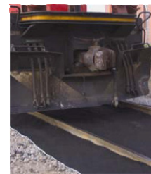
Rail Mat Absorbente para proteger la solera de las vías.
